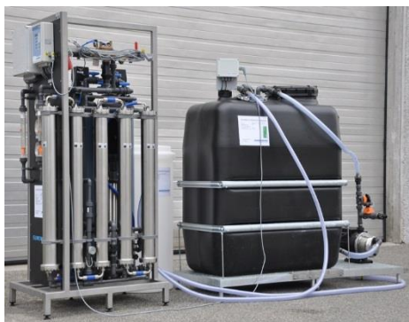
Rys. 5. Stacja Odwróconej Osmozy firmy Eurowater [14]
