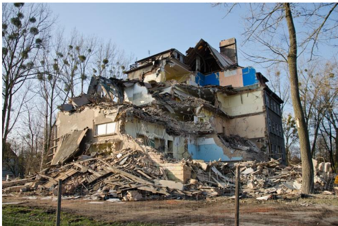
Rys. 3. Prace wyburzeniowe z powodu szkód górniczych [12]
