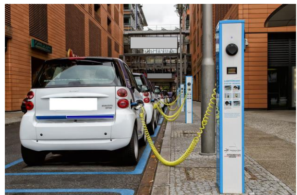
Rys. 1. Stacja ładowania pojazdów elektrycznych małej mocy, czas ładowania 6-8 godzin [11]
