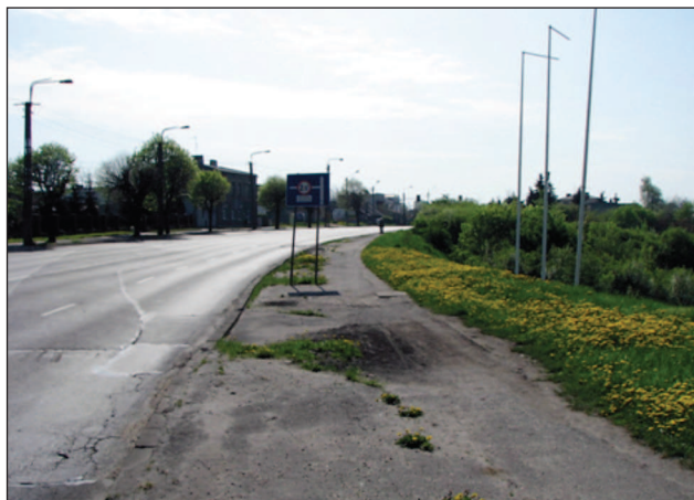
Fot. 5. Widoczne nierówności i zapadnięcia w jezdni i chodniku od strony południowej wzdłuż ul. Łódzkiej w Kaliszu, maj 2013, fot. Z. Małecki
