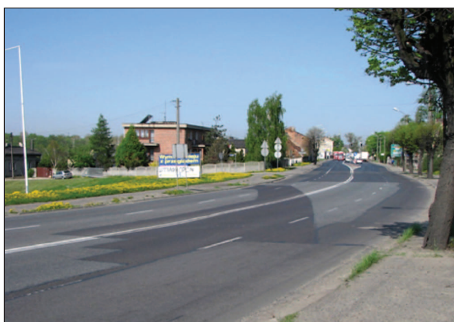
Fot. 4. Widoczne naprawione doraźnie nierówności powierzchni jezdni w ul. Łódzkiej w Kaliszu
