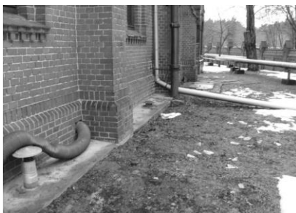
Rys. 1. Stan zachowania murów Stacji Pomp Miejskich Wodociągów w Bydgoszczy (rok budowy - 1900)
