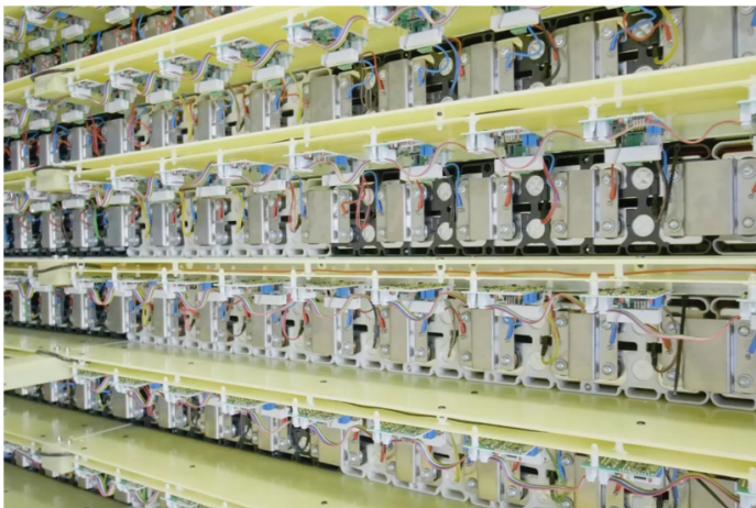
Rys. 4. Baterie litowo-jonowe zamontowane w jednym z kontenerów
