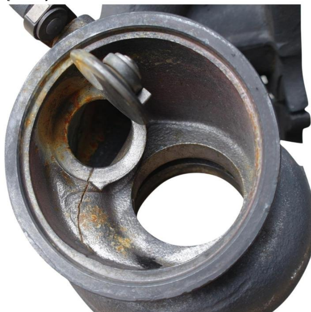
Rys. 3. Widok pękniętej obudowy części turbinowej w okolicy zaworu upustowego
