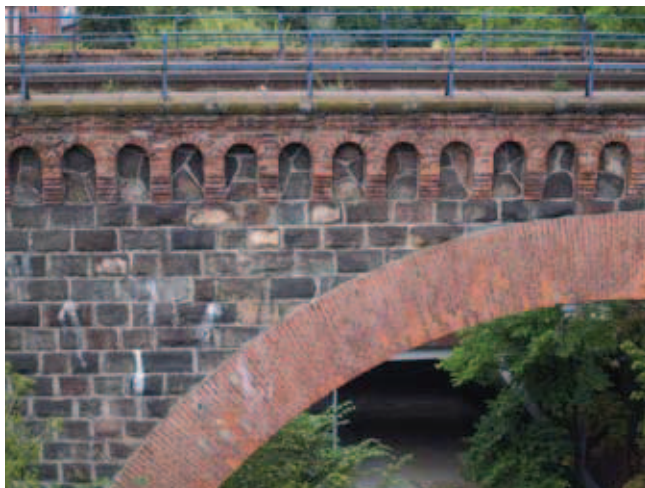
Rys. 8. Wychylenia z poziomu płyt granitowych wieńczących elewację wiaduktu oraz skorodowane barierki ochronne
