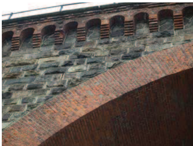
Rys. 7. Postępujące zniszczenia stylowego gzymsu, poniżej złączenia i spękania ceglanych elementów drobnowymiarowych
