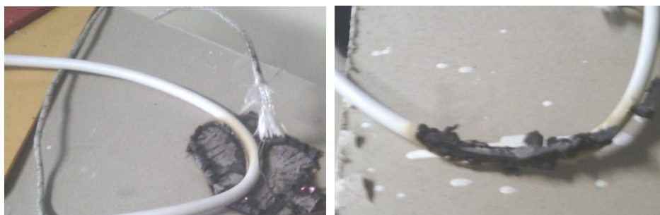
Rys. 4. Skutki przegrzania nieogrzewanej warstwy ścianki
