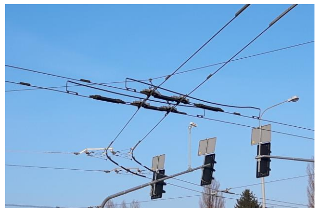
Rys. 13. Skrzyżowanie sieci trakcyjnej, fotografia: Michał Krawczyk
