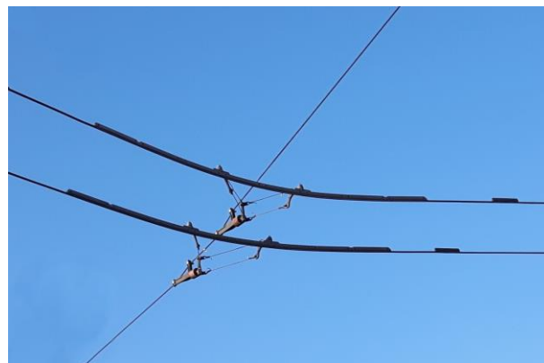
Rys. 10. Mocowanie przewodów sieci trakcyjnej na łuku nowego typu za pomocą dwóch wieszaków, fotografia: Michał Krawczyk
