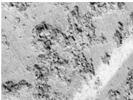
Rys. 1. Powierzchniowe złuszczenia nawierzchni
