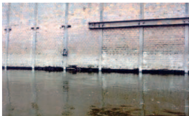
Rys. 4. Dolny fragment muru. Pod murem ceglanyym stwierdzono ubytki drewnianej ścianki szczelnej
