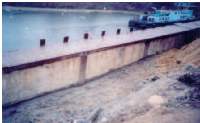
Rys. 6. Osuwisko gruntu za murem, które uwidoczniło się w trakcie robót remontowych wykonywanych w 2002 roku
