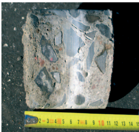
Fot. 7. Widok odwiertu, w którym stwierdzono segregowanie struktury betonu
