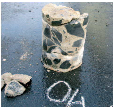
Fot. 8. Widok odwiertu, w którym stwierdzono szerokie rozwarstwienie struktury betonu
