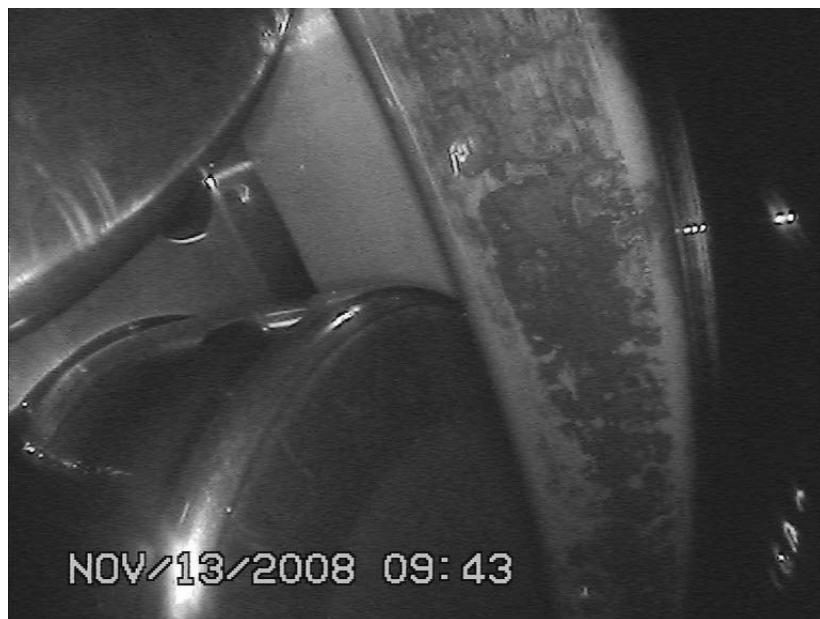
Rys. 11. Wideoskopowe zdjęcie łożyska wałka przekładni z widocznym zmatowieniem bieżni zewnętrznej
