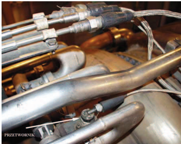
Rys. 1. Miejsce montażu akcelometru nad wytwornicą spalin
