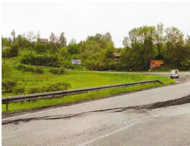
Rys. 1.4. Uszkodzenia DK nr 75 [9]
