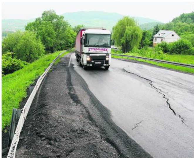
Rys. 1.3. Uszkodzenia DK nr 75 [8]
