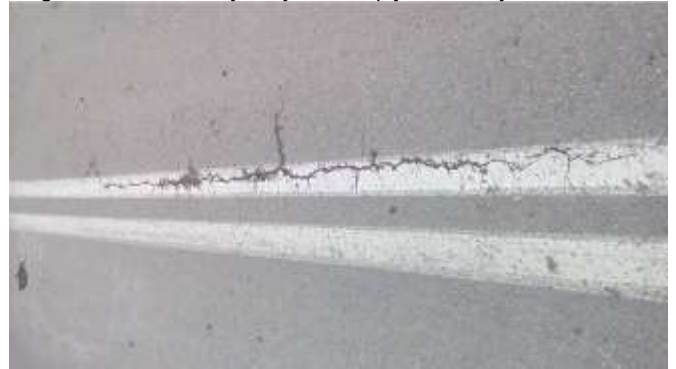
Rys.1.3. Rysa podłużna wzdłuż osi jezdni nawierzchni drogi wojewódzkiej
