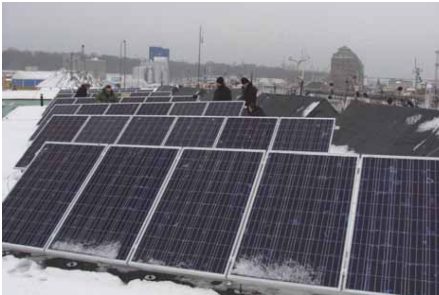
Rys. 1. Instalacja PV o mocy 10 kWp
