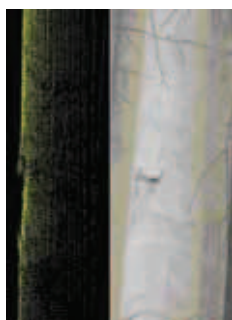
Rys. 5. Widok uszkodzenia kolumny (skan i zdjęcie)
