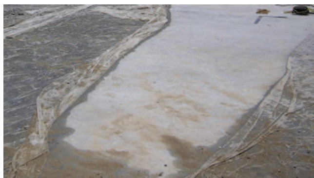
Rys. 10. Wadliwa pielęgnacja płyty
