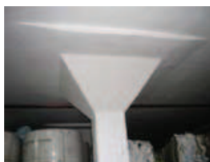
Rys. 3. Przykład strefy podporowej stropu płaskiego z lat 30. ubiegłego stulecia w fabryce celulozy we Włocławku
