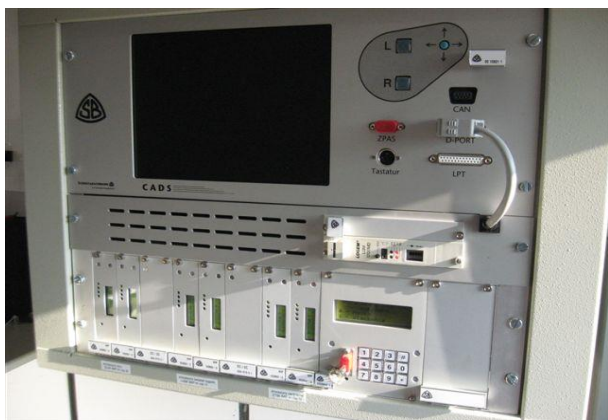
Rys. 7. Widok kontenera z komputerem diagnostycznym oraz procesorami modułowymi i klawiaturą serwisową w sygnalizacji BUES 2000 [1]
