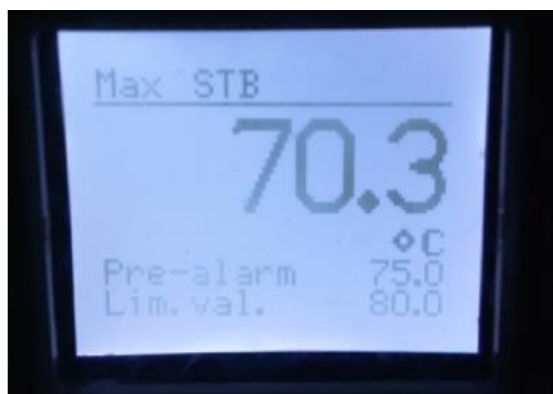
Rys. 21. Zabezpieczeniowy monitor temperatury z zabezpieczeniowym ogranicznikiem temperatury STB/STW [opracowanie własne]
