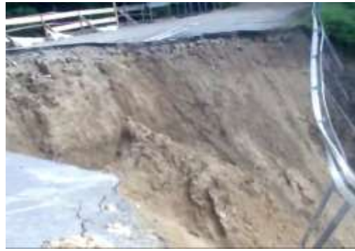
Rys. 9. Przykład uszkodzenia drogi we fliszu karpackim spowodowane osuwiskiem po długotrwałych deszczach w 2010 roku Kurów – droga 975 nad jeziorem Rożnowskim [8]
