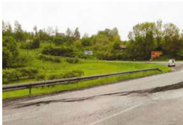
Rys. 5. Uszkodzenia na DK 75 w km 52+350 – 52 + 381 (2010 r.) [7]
