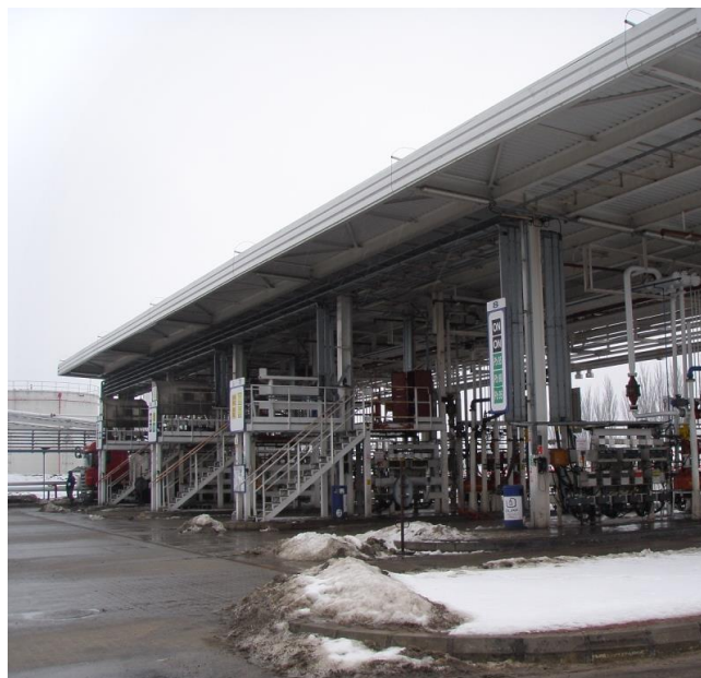
Rys. 1. Nalewnia autocysternowa w Bazie Paliw Nr 1 w Koluszkach
