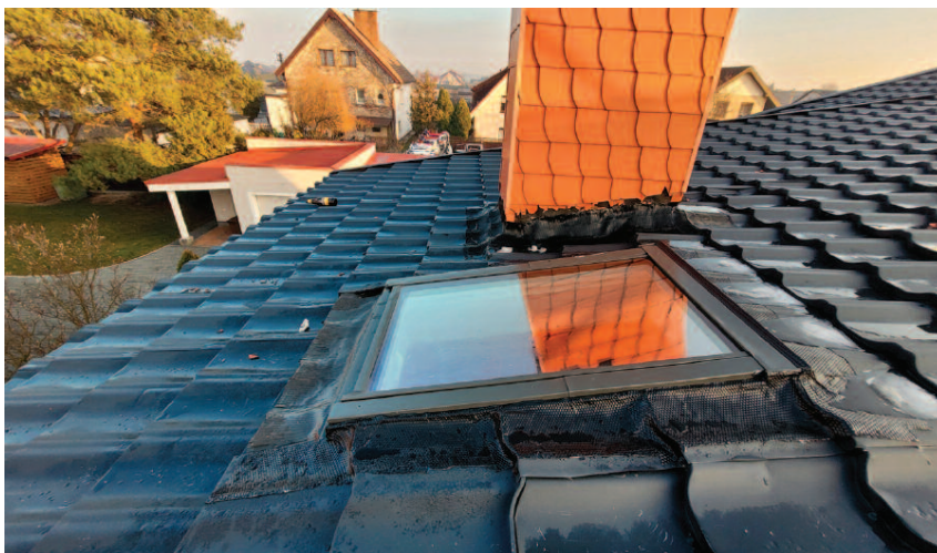
Fot. 1. Dach opisany w przykładzie 1. Okna połaciowe zamocowane przy nachyleniu połaci dachowej mniejszym niż 15° przeciekają ze względu na konstrukcję ich wewnętrznych uszczelnień
