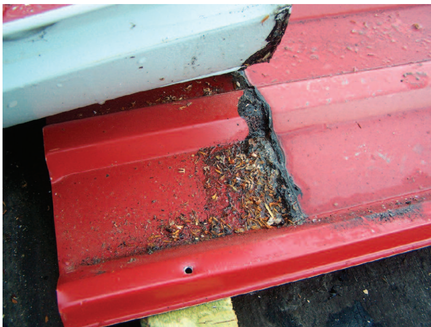
Fot. 2. Zwykły zakład między panelami blachy trapezowej będzie przeciekał w przypadku niewielkiego nachylenia (5°) nawet po uszczelnieniu masą bitumiczną, ponieważ blachy stale się kurczą i rozszerzają (ruchy termiczne)
