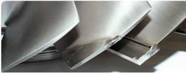
Rys. 9. Wykruszone pióro bliska w trakcie naprawy [18].
