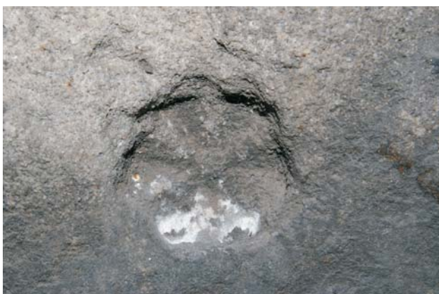
Ryc. 15. Dno otworu wiertniczego zachowane na powierzchni bloku piaskowca (zaplecze budynku A-1 Politechniki Wrocławskiej; długość pola widzenia 15 cm)
