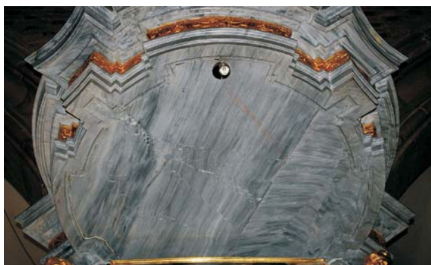
Rys. 10. Baldachim ambony katedry wrocławskiej – zapis zjawisk tektoniki dysjunktywnej w laminowanym marmurze. Fot. P. Zagożdżon
