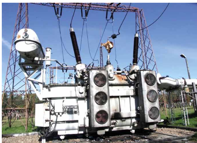
Rys. 8. Uszkodzony w wyniku eksplozji izolator przepustowy 220 kV fazy A1 w transformatorze o mocy znamionowej 160 MVA
