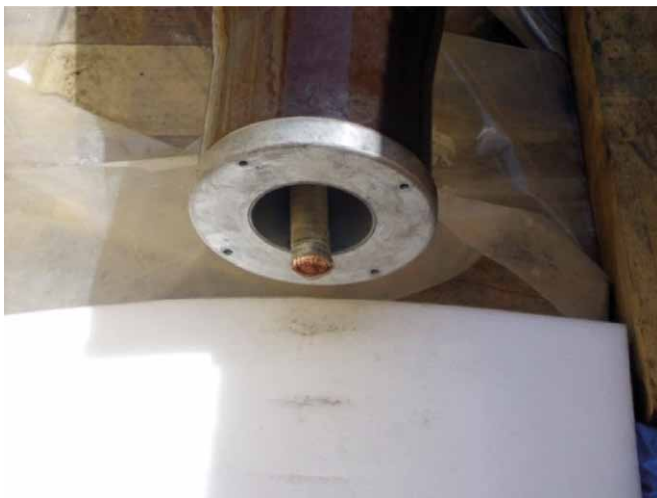
Rys. 5. Widok pierścieni aluminiowych (3) izolatora fazy B1 i izolatora fazy C1
